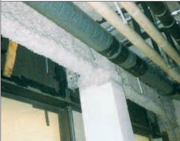
Träger mit Spritzasbest, Stützenverkleidung mit Promasbestplatten
