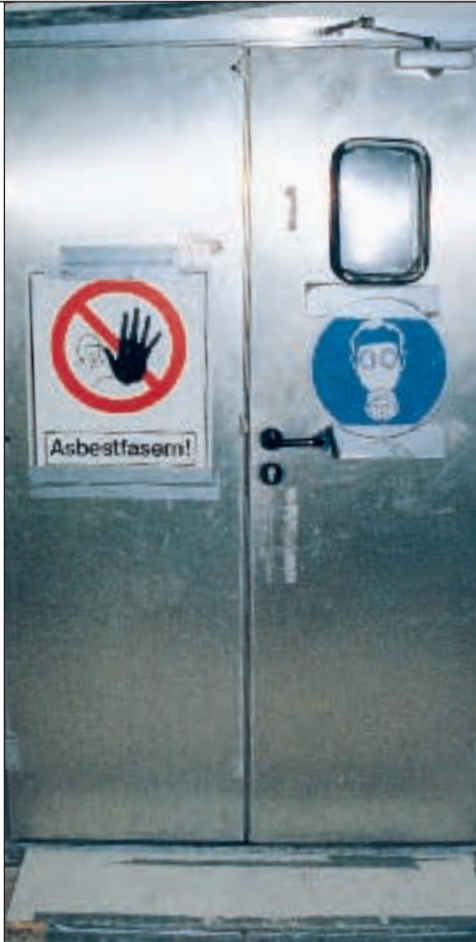
Materialschleuse, zwangsverriegelt, Kammer 1
